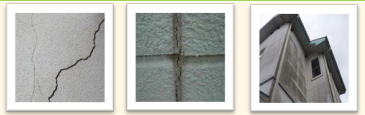
ヒビがはいつている シーリングの劣化 カビ・コケがはえている
